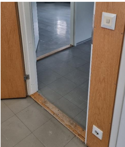
Kuva 7: Tuvan ja odotushuoneen 2 cm kynnyks.
